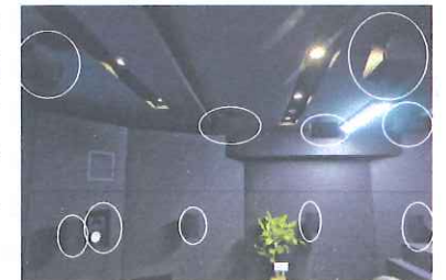
天井や壁に多数設置されたスピーカー群 (円内がスピーカー)
